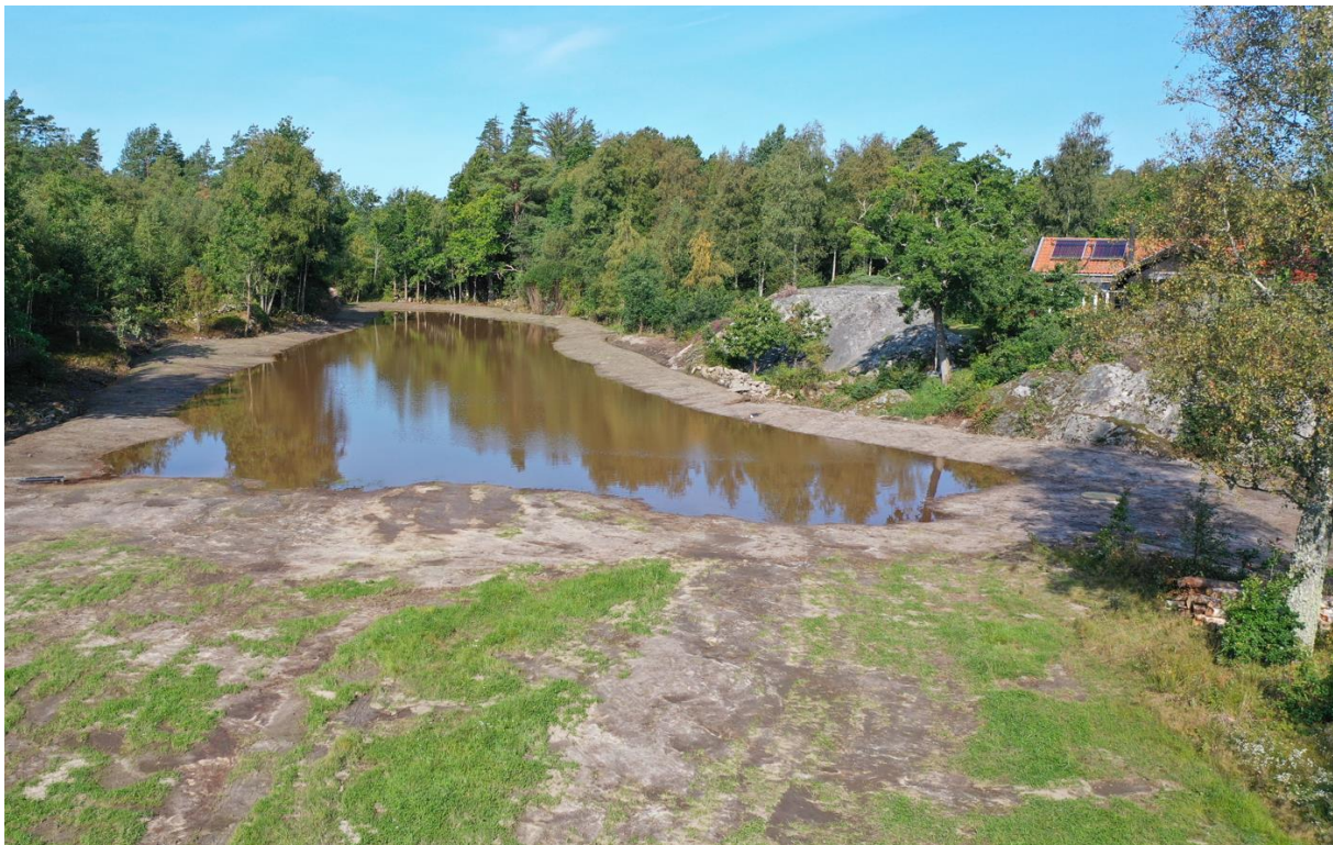
Figur 11. En vecka efter entreprenadens slutförande har vattnet fyllt upp och nått sin normala nivå. Foto: Kristian Littke, 2023-08-24
