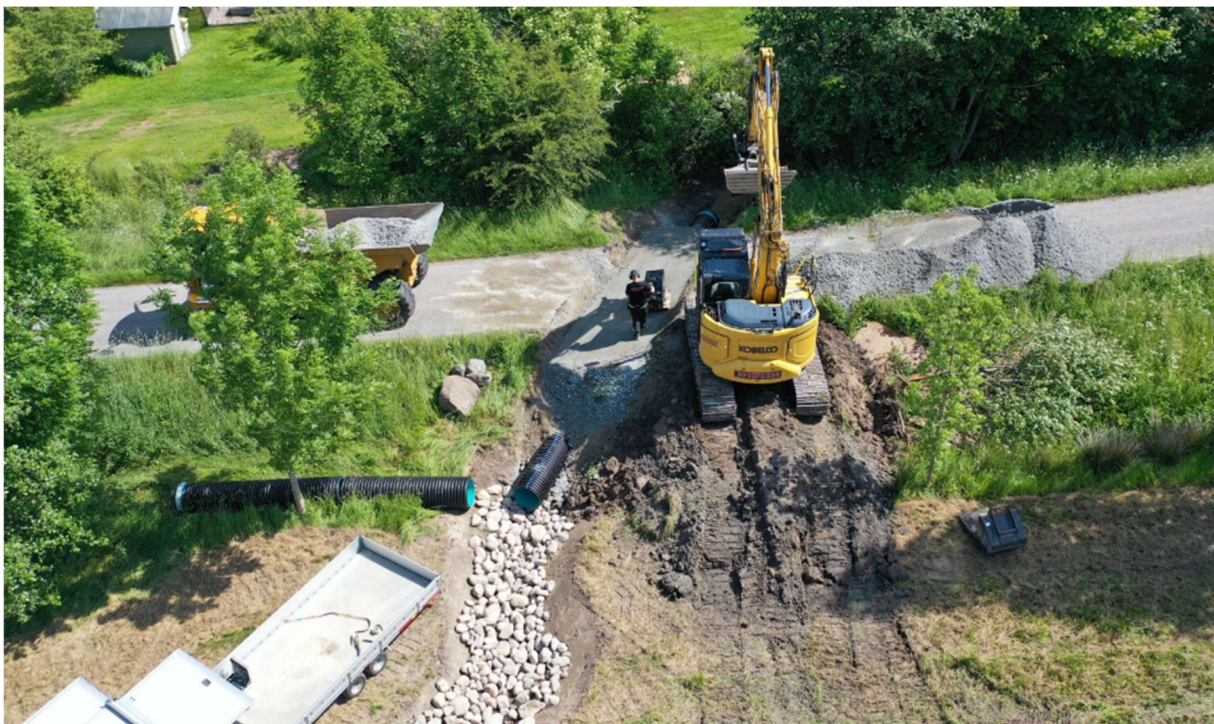
Figur 5: Under genomförandeskedet fanns behov av att gräva av en mindre väg för att lägga en kulvert och snabbt lägga igen den igen så att den blev brukbar. Detta var en kritisk del av entreprenaden och kunde klaras av på ca två dygn. Foto Kristian Littke, 16 juni 2025.
